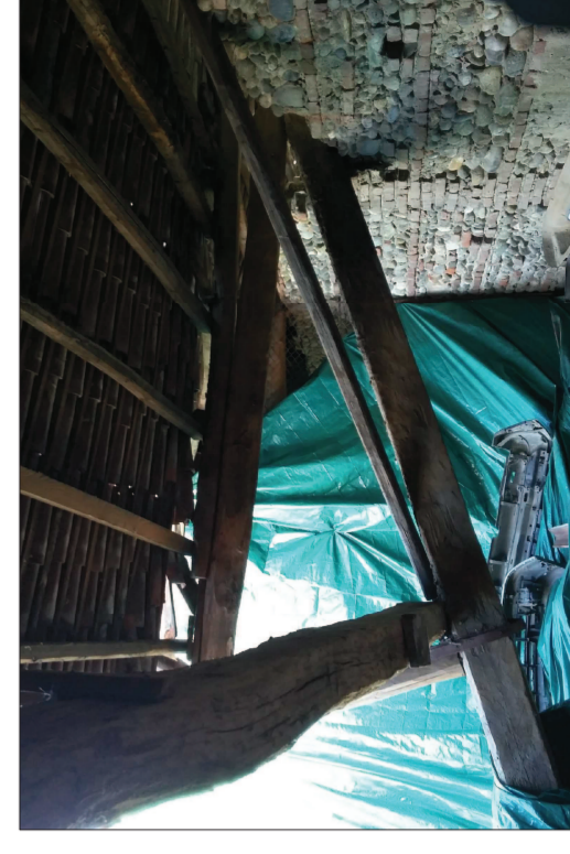
FOTO 4 - Particolare tetto crollato
