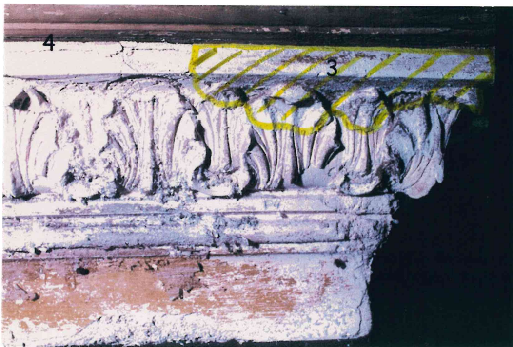
Particolare della zona del cornicione studiata in cui sono segnati i punti di prelievo ed è evidenziata in tratteggio giallo l'area in cui vi è la stuccatura di rifacimento
