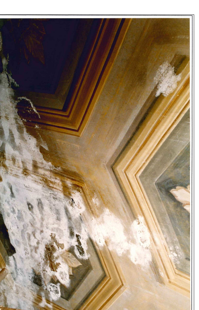
PORZIONE DEGRADATA DECORAZIONE VOLTA
