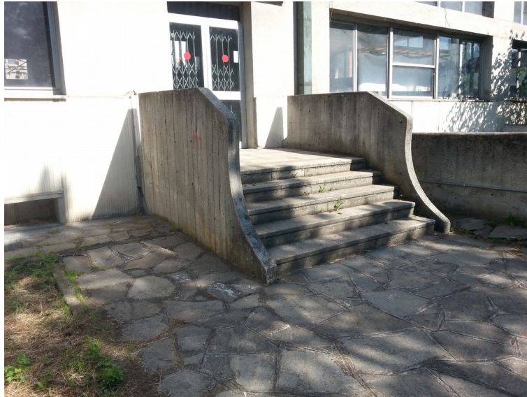
1. Foto: Vista della scala lesionata
