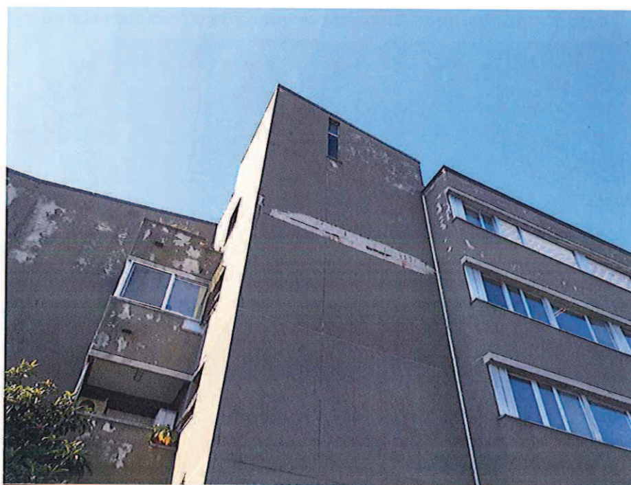
Foto 2 – Fabbricato A - Uffici – Distacchi di intonaci su facciate esterne
