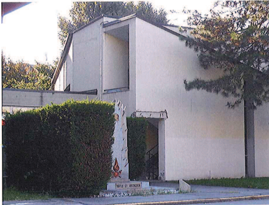
Foto 3 – Auditorium - Distacchi di intonaci su facciate esterne
