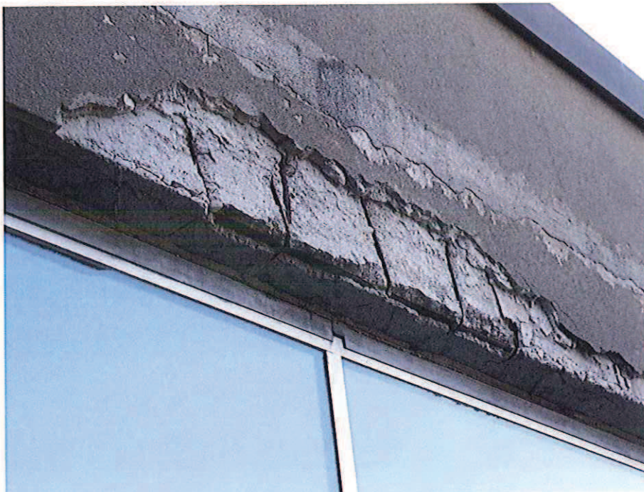
Foto 4 – Fabbricato B – Camerate Torretta Centrale – Distacchi di intonaci
