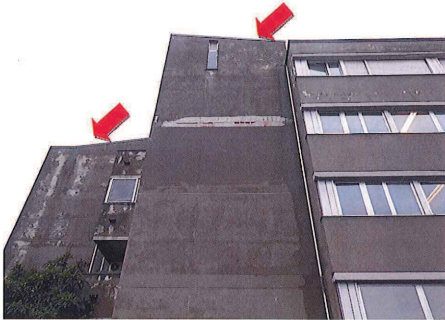
Foto 8 – Fabbricato A – Corpo scale alloggi – Distacchi di intonaci su facciate esterne
