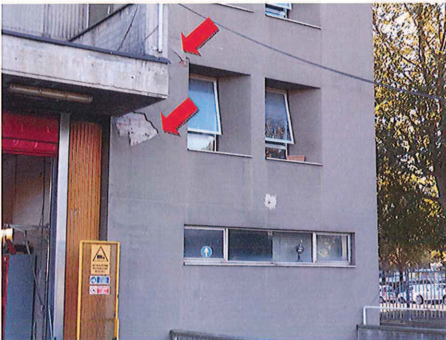
Foto 6 - Intonaci delle facciate ammalorati (zona uffici - zona SAF)
