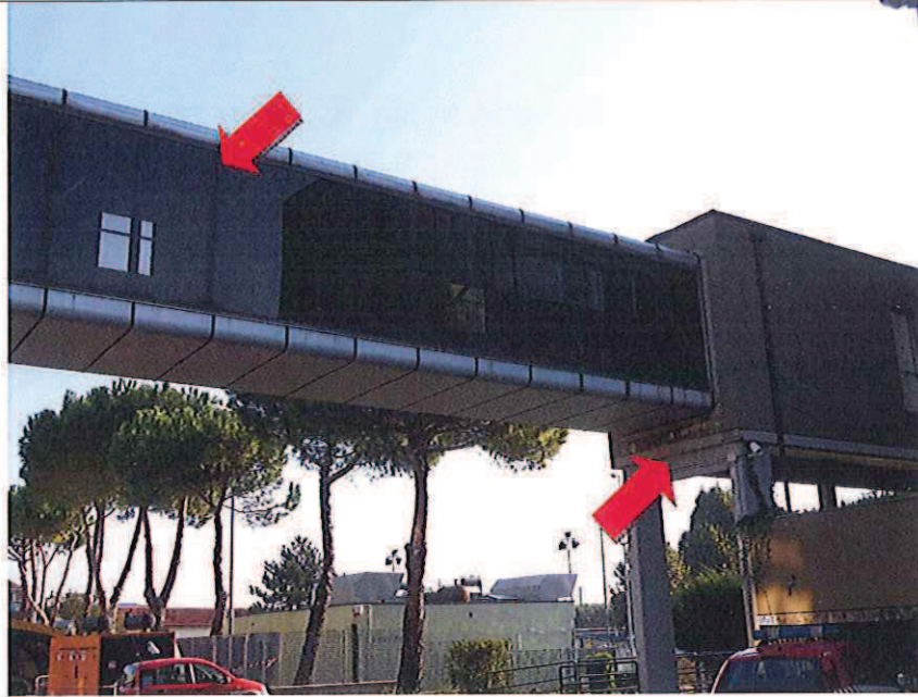
Foto 9 – Passerella collegamento Fabbricato A/B – Infiltrazioni
