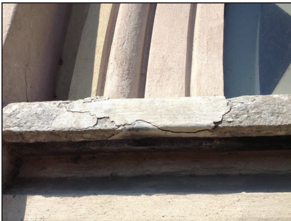
FOTO N. 6 – Mole Antonelliana, fenomeni di distacco delle stuccature degli elementi lapidei
