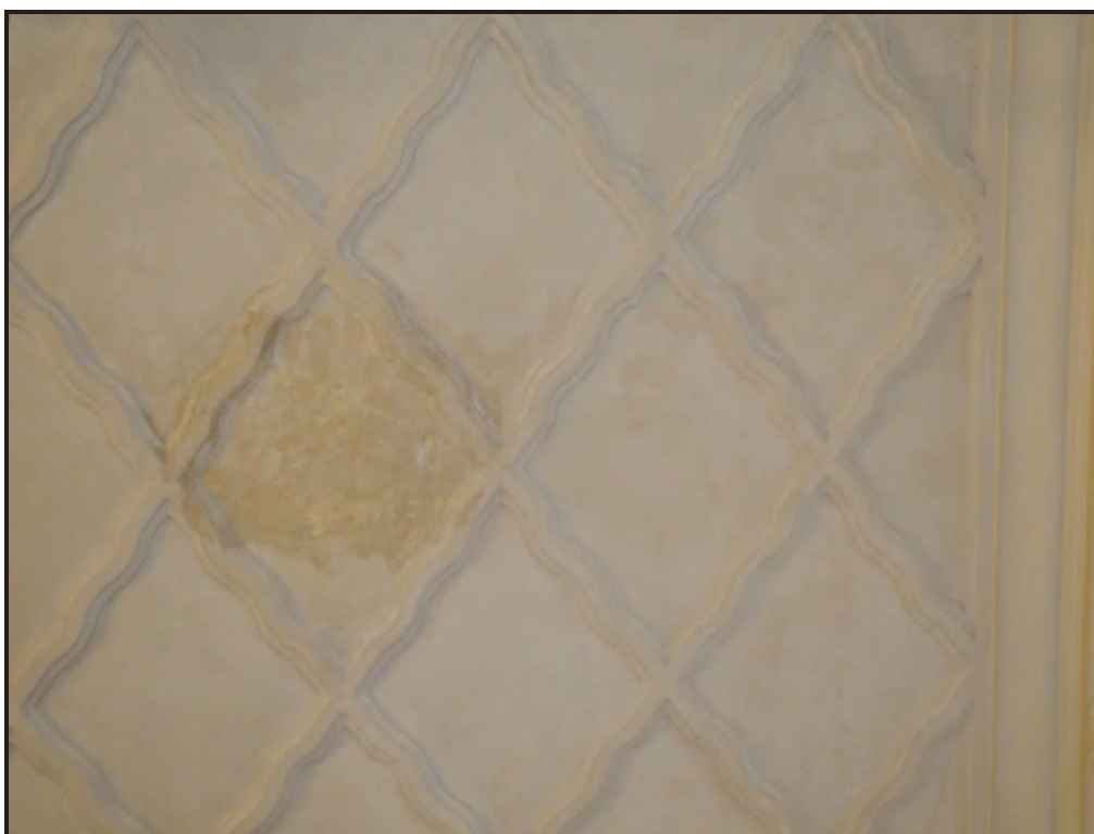
FOTO N.6 – Galleria, inquadramento generale del degrado
