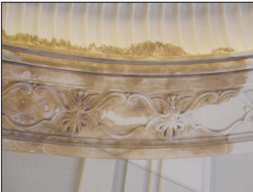
FOTO N.2 – Sala Concerti, particolare del degrado degli stucchi
