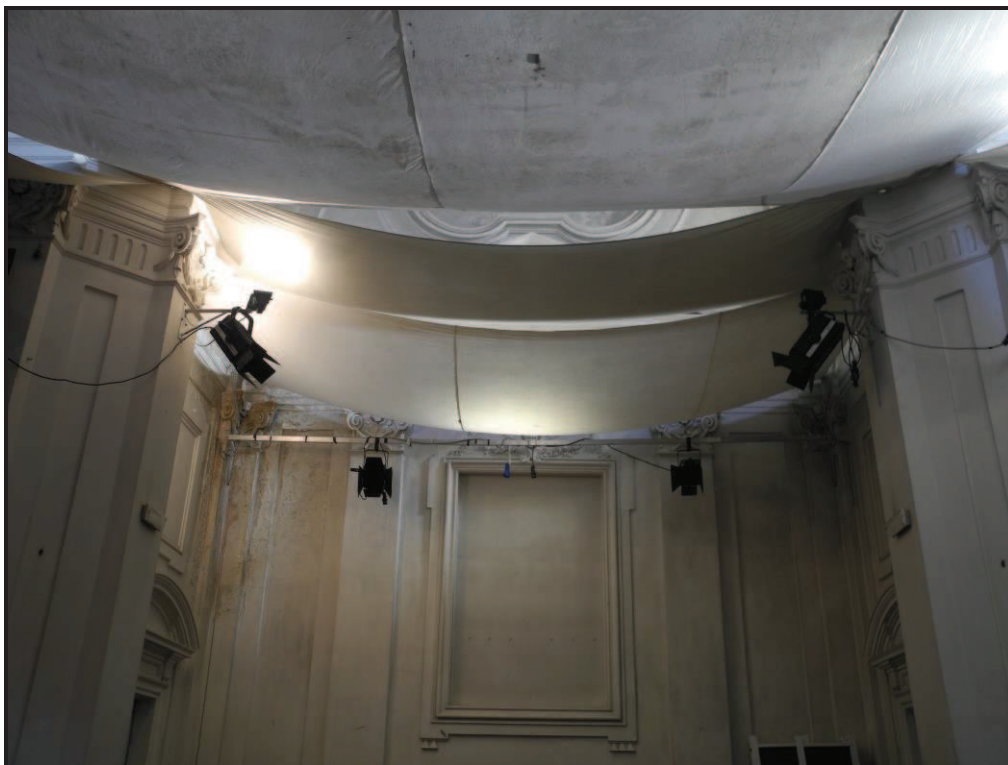
FOTO N.1 – Abside Centrale della Cappella dell'Ex Cimitero, inquadramento generale del degrado
