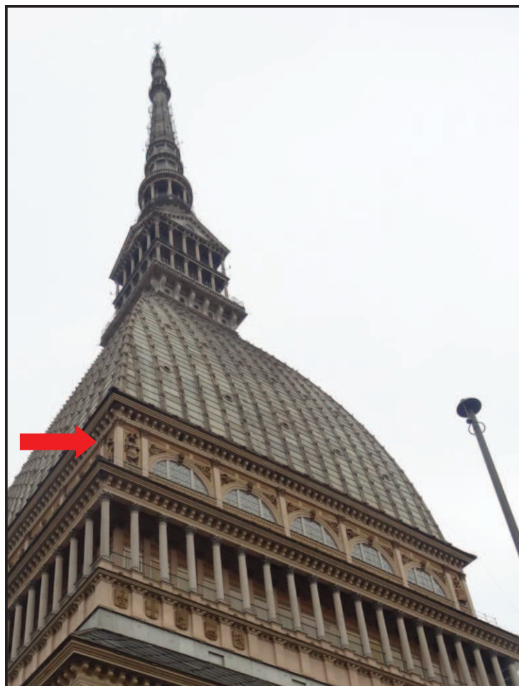
FOTO N.1 – Mole Antonelliana, localizzazione dell'area interessata dal degrado
