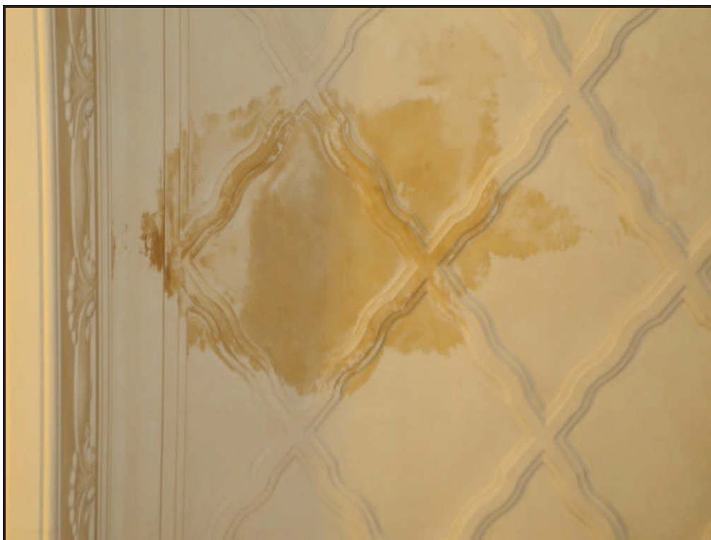
FOTO N.5 – Galleria, inquadramento generale del degrado
