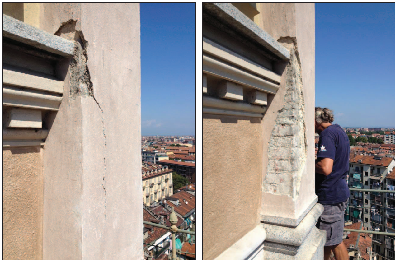
FOTO NN.2, 3 – Mole Antonelliana, fenomeni fessurativi e di distacco degli intonaci
