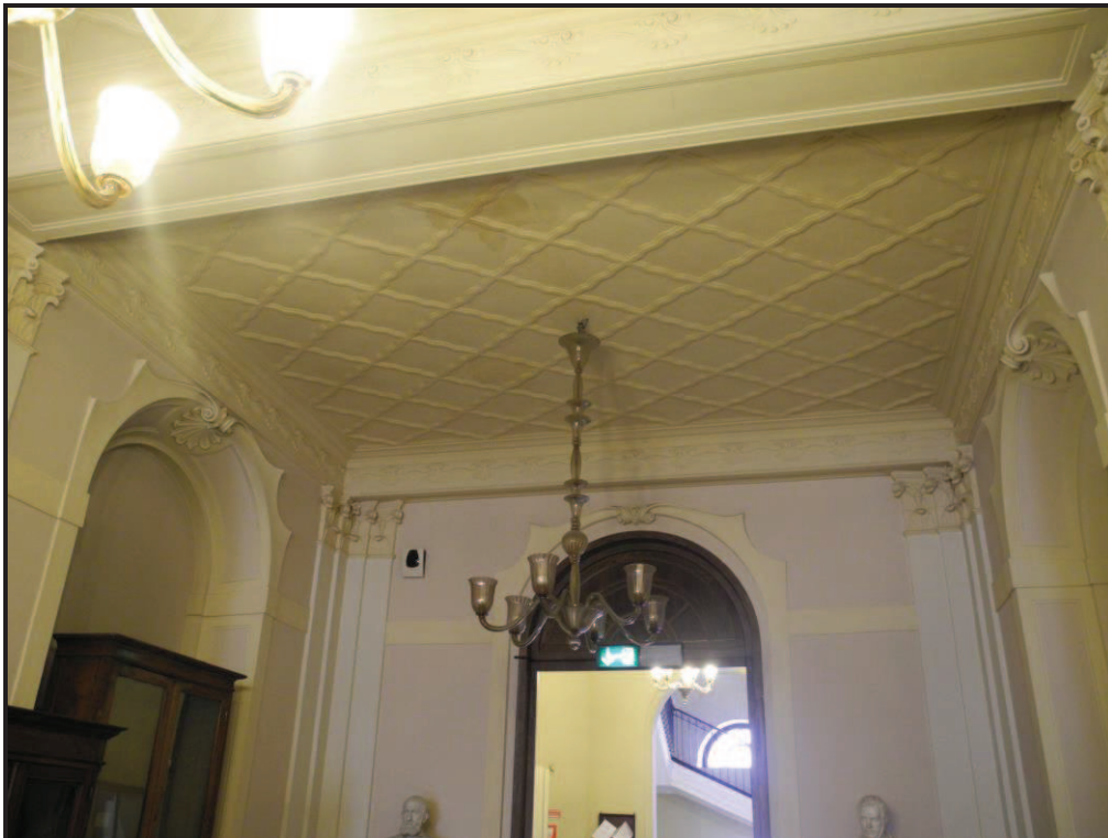
FOTO N.4 – Galleria, inquadramento generale del degrado
