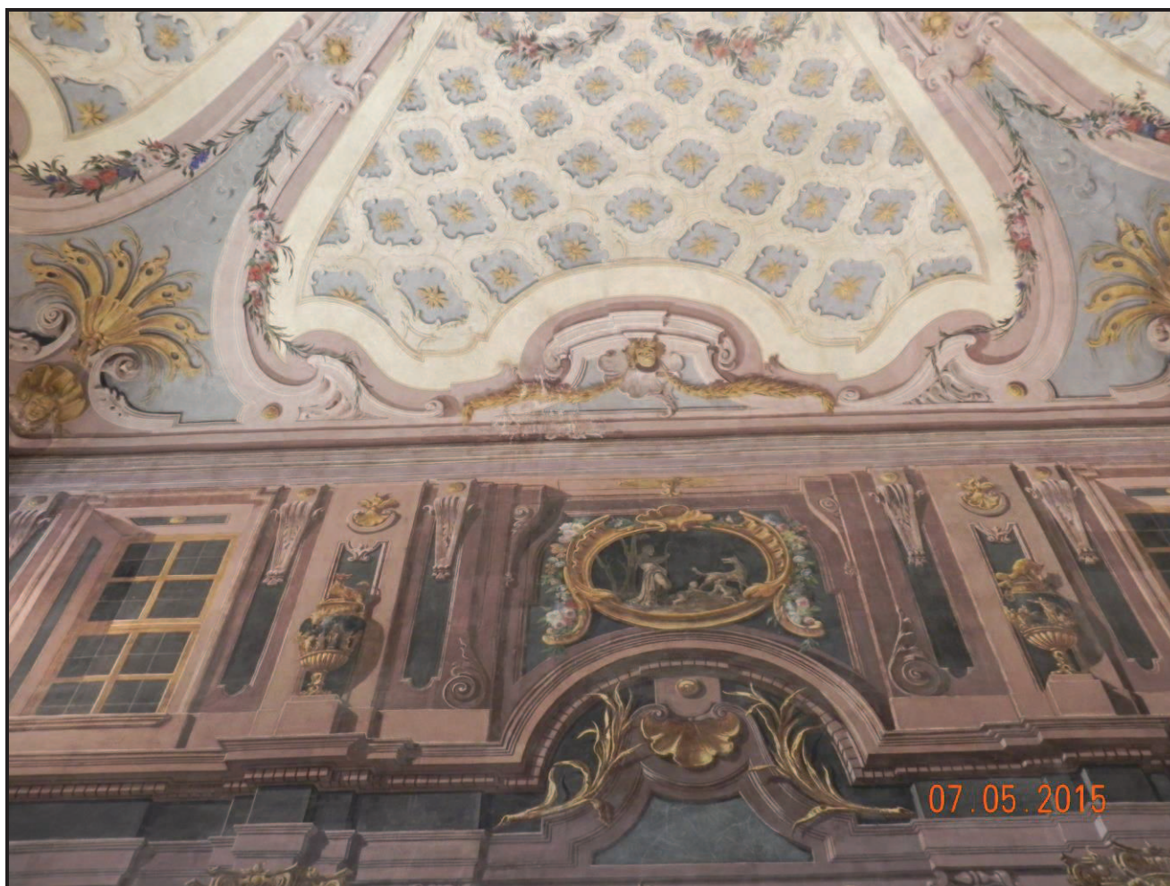
FOTO N.2 – VILLA AMORETTI Salone Centrale - volta, localizzazione dell'area di degrado nel lato nord
