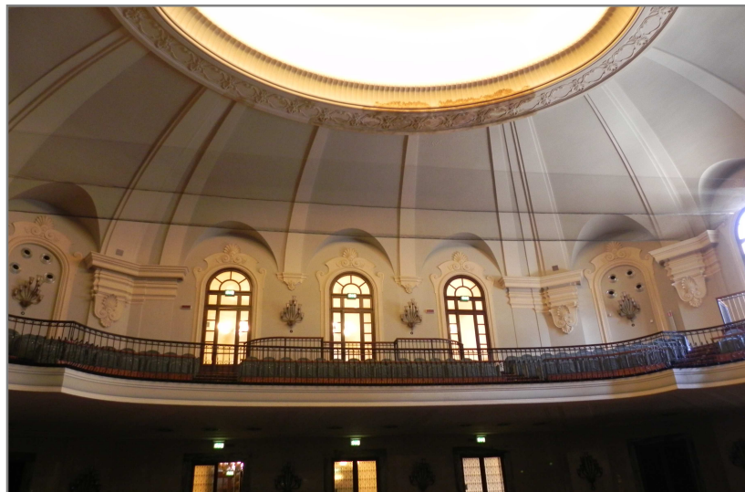
Conservatorio "G. Verdi" – Interventi di restauro – Sala concerti e controsoffitto del Foyer – Risistemazione di macchie sugli apparati decorativi dovute a infiltrazioni d'acqua.
