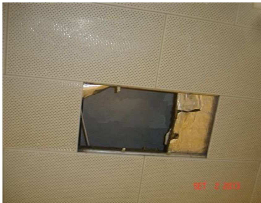
foto 2: particolare pannelli radianti
