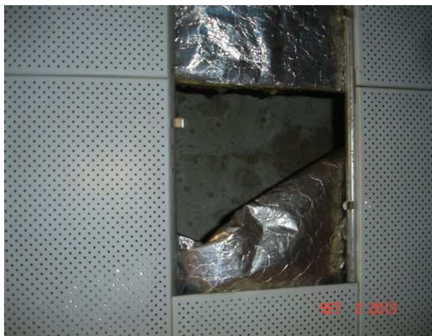
foto 3: particolare pannelli radianti e materiale isolante
