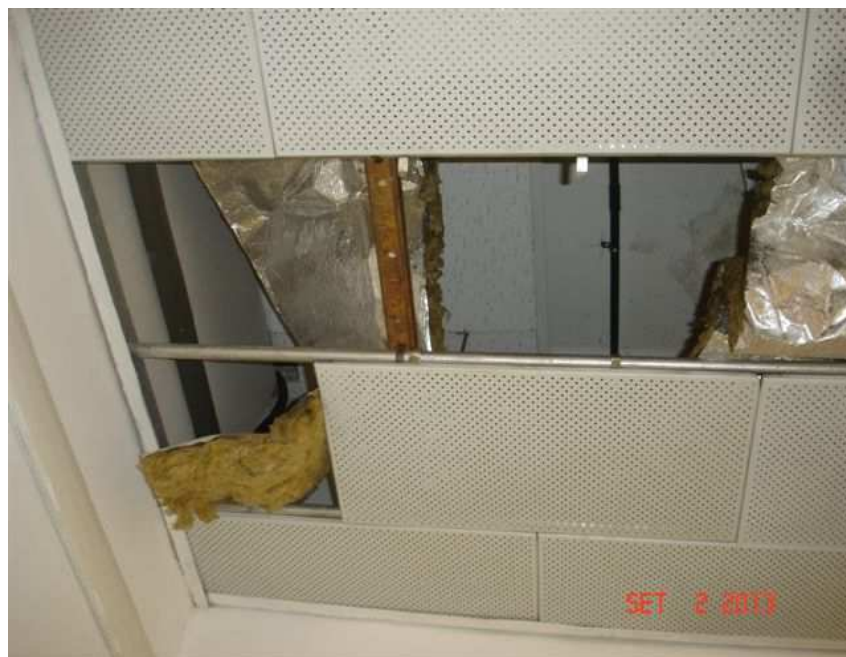
foto 4: particolare pannelli radianti e materiale isolante
