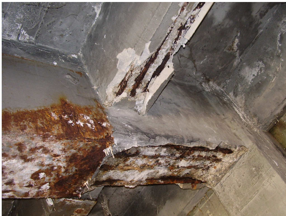
Foto 2 – Degrado delle strutture
