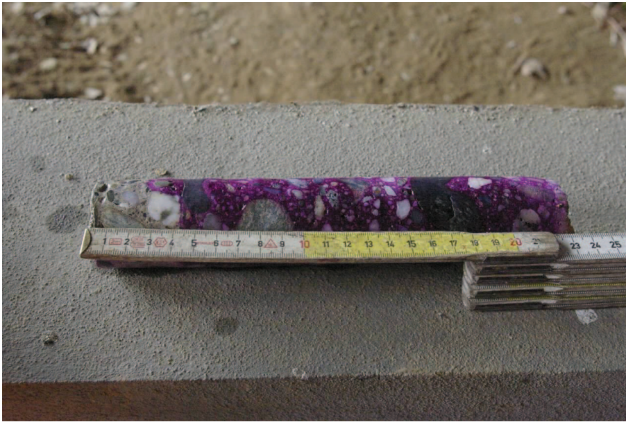
Carotaggio 6 su pilastro interno, profondità carbonatazione cm 4,5÷5,0
