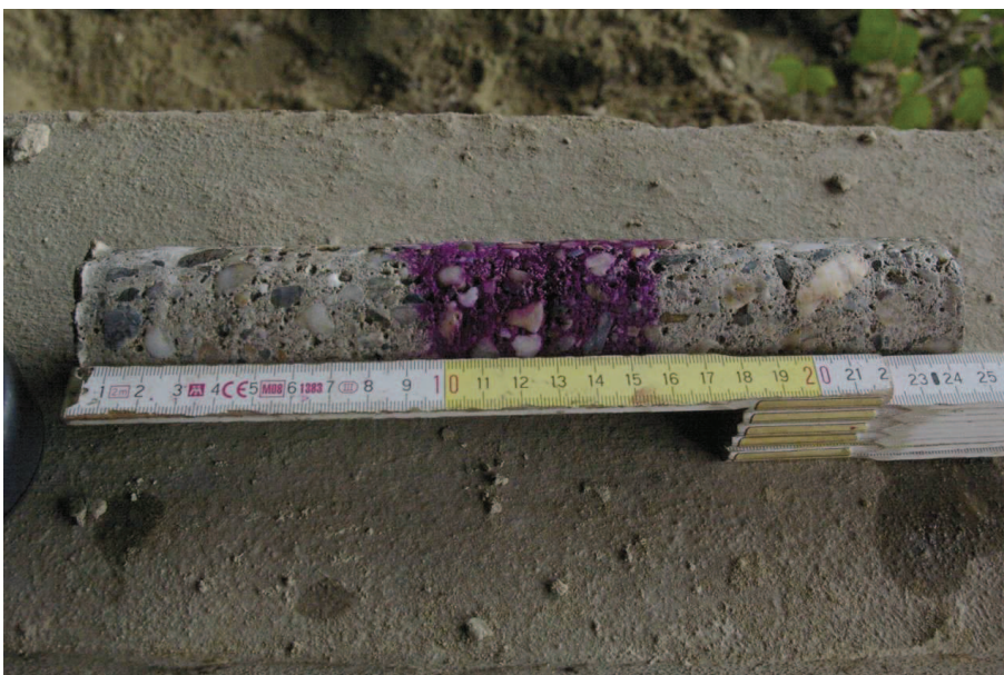
Carotaggio 5 su trave impalcato; carbonatazione sulle testate campione di cm 8÷9
