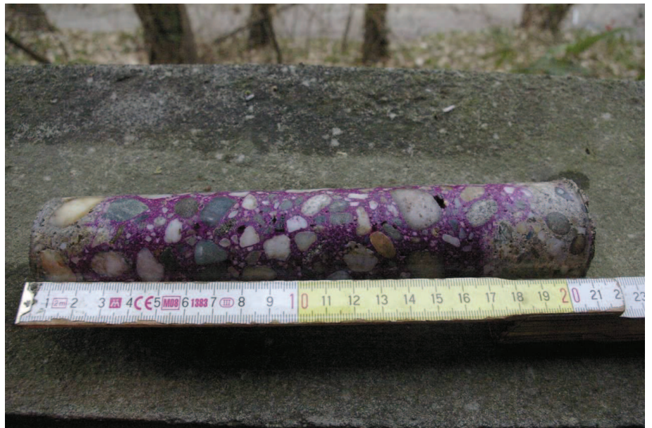
Carotaggio 4 su trave di collegamento; carbonatazione sulle testate di cm 3÷4
