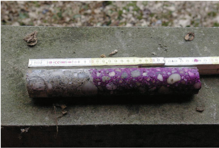
Carotaggio 3- pilastro - Carbonatazione 10 cm
