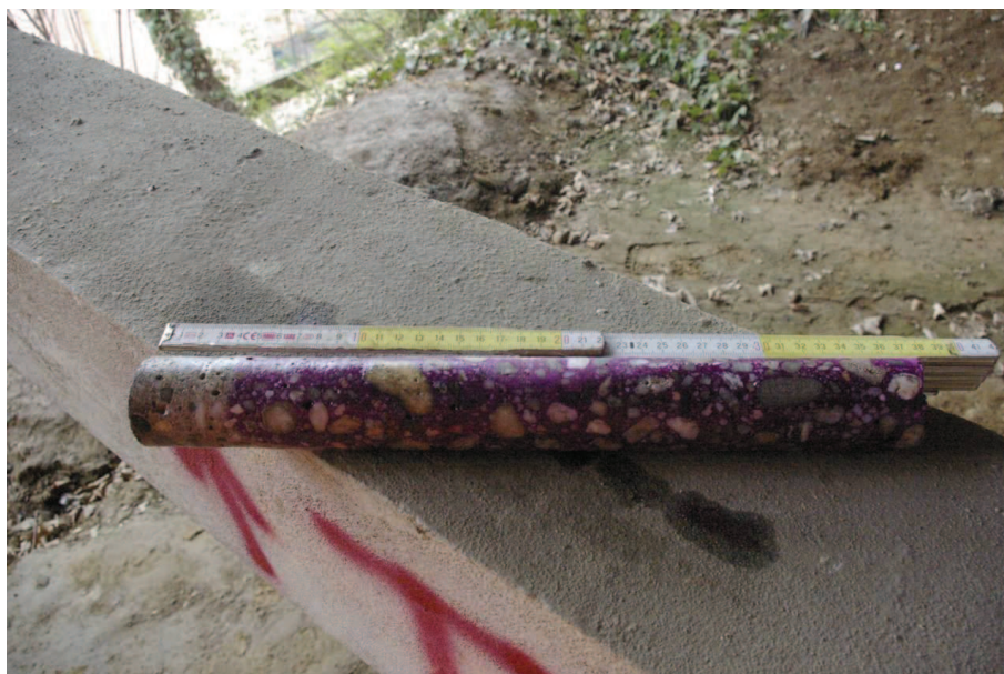
CAROTAGGIO 8, traverso soletta - profondità carbonatazione cls cm 4,5
