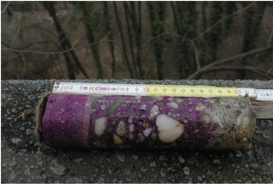
Carotaggio 1- soletta - Carbonatazione cm 4÷5 all'intradosso
