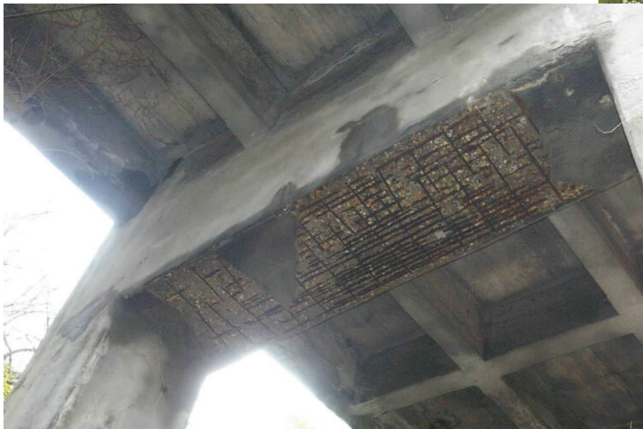
intradosso pulvino pila con completo distacco dell'intonaco di copriferro
