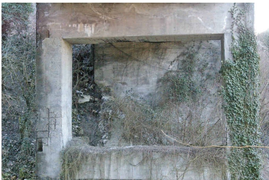
erosione spigolo spalla sinistra a monte e del terreno marnoso di fondazione
