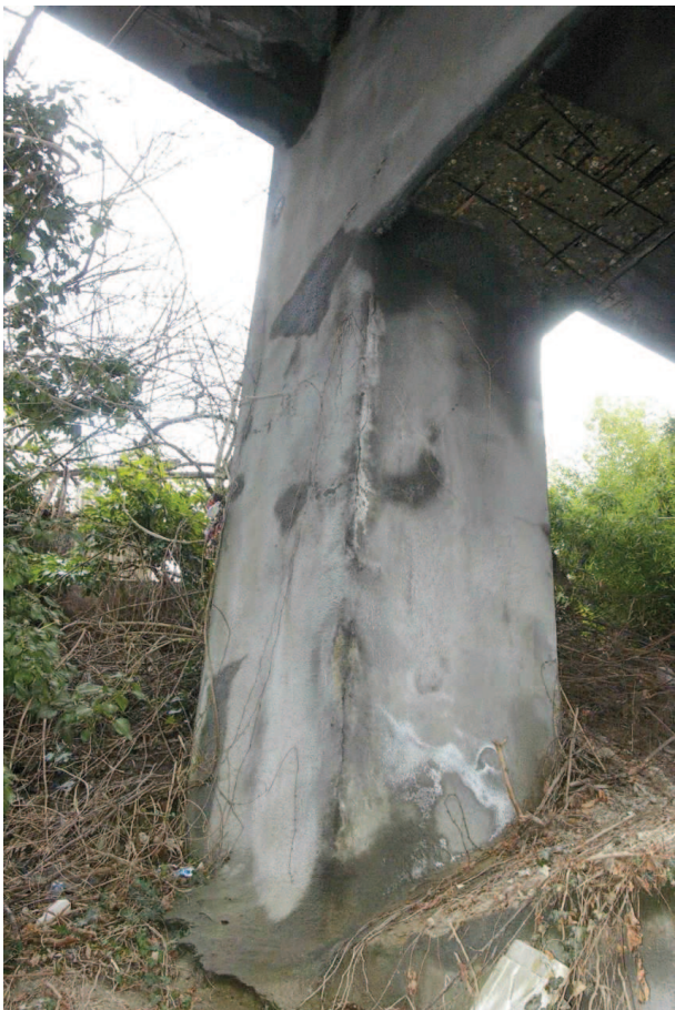
pilastro di monte della pila, con fessurazione sullo spigolo
