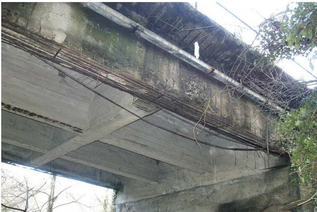
Foto 3 – Degrado delle strutture
