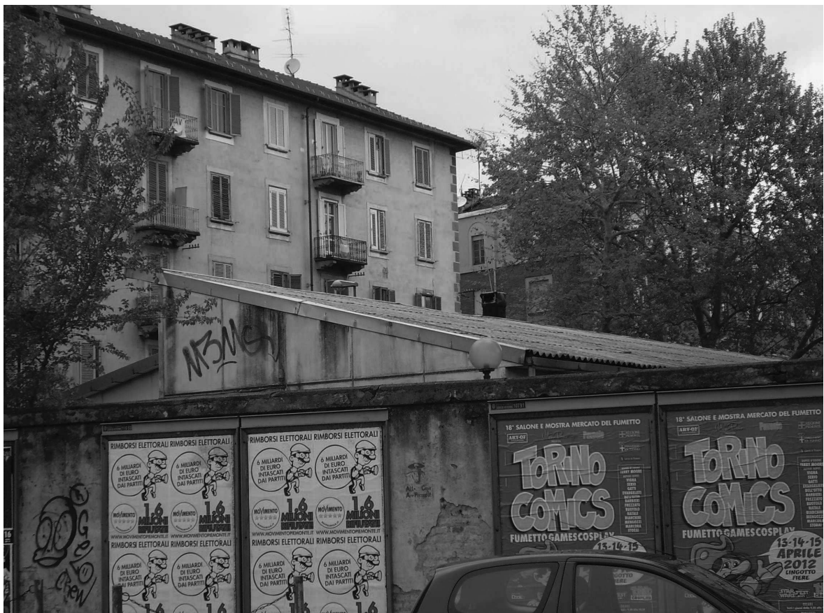
FOTO N. 4- EDIFICIO "C" COPERTURA IN AMIANTO VISTA DA VIA FREJUS
