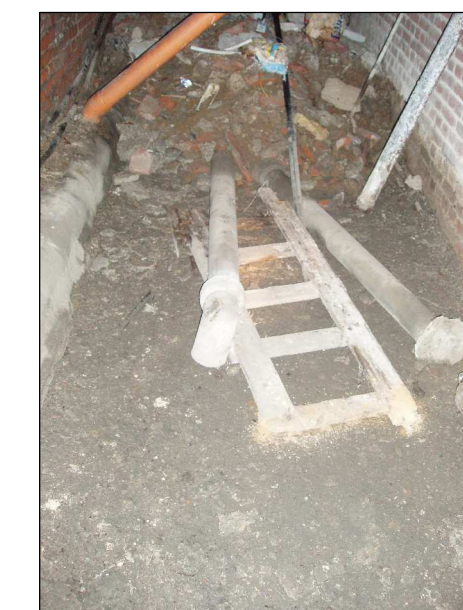
TUBAZIONI IN AMIANTO
