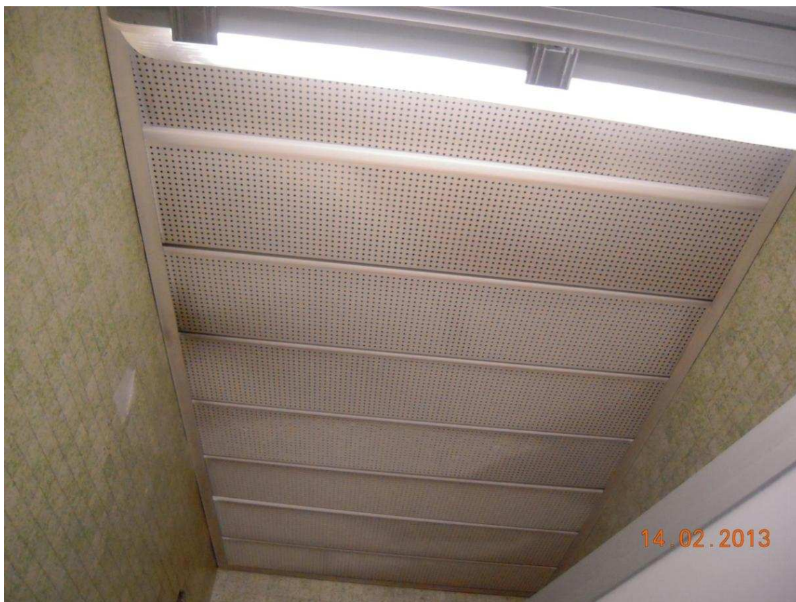
Foto 21 – piano rialzato – controsoffitto metallico forato presente nei servizi igienici
