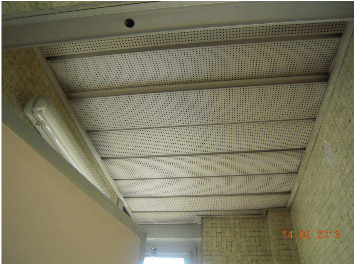
Foto 23 – piano primo –controsoffitto in doghe metalliche forate presente nei servizi igienici
