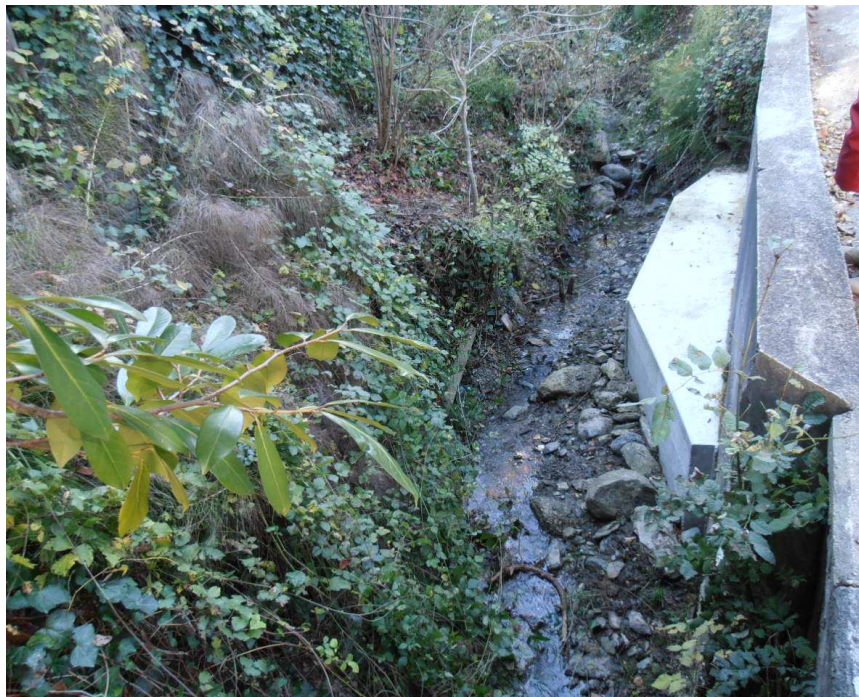
Rio Val San Martino in Via Pinin Pacot 28/30, erosione del fondo scorrevole. In sponda destra visibile manufatto in c.a. realizzato dal frontista nel corso del 2012
