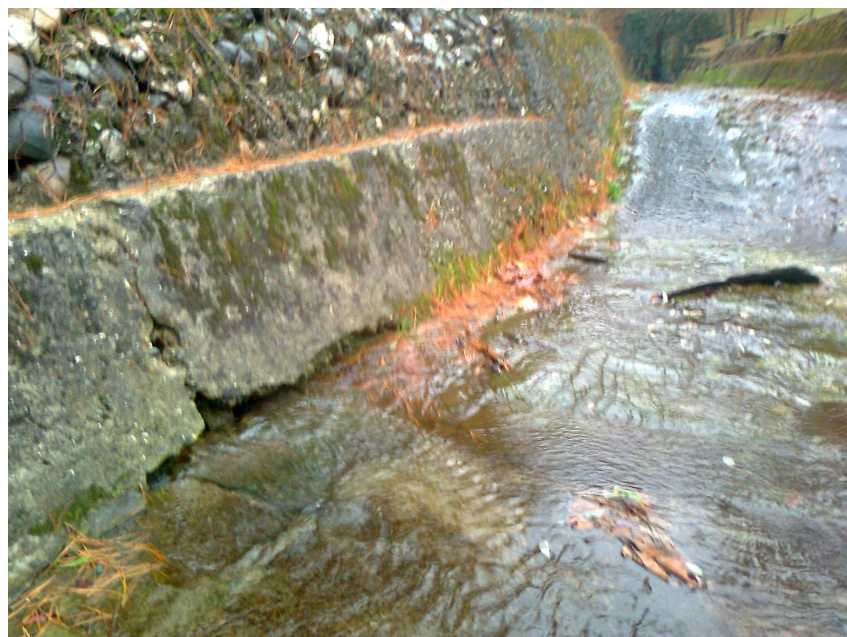
Rio Val San Martino, fuoriuscita di acqua dal retro della gabbionata danneggiata infiltratasi più a monte
