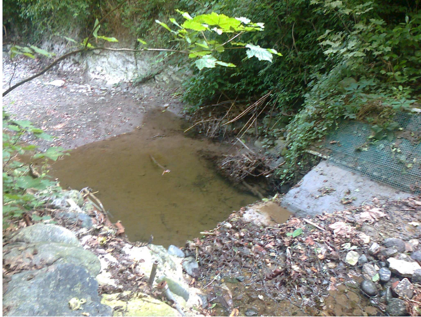
Rio Reaglie in str. Forni e Goffi, erosione al piede della briglia
