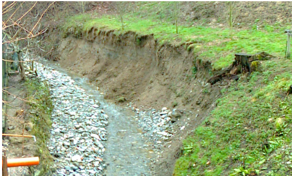
Rio Costa Parigi, cedimento tratto di sponda sinistra nell'area a Parco naturale della collina di Superga – Regione Piemonte (prima dell'intervento del Comune di S. Mauro)
