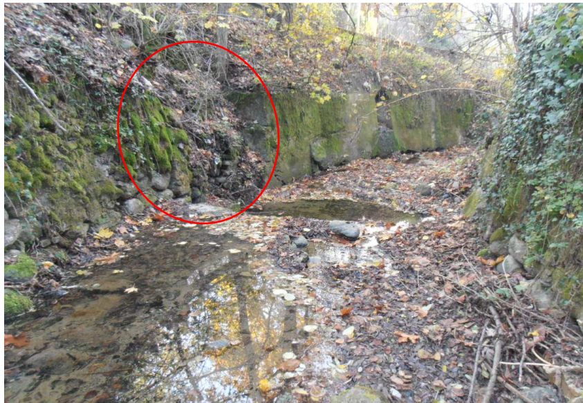
Rio Reaglie in str. Forni e Goffi, erosione al piede della briglia, scalzamento muro in c.a. e dissesto e cedimento di tratto di muro in pietrame in sponda sinistra (evidenziato in rosso. Presenza diffusa in alveo di depositi e materiali di risulta.
