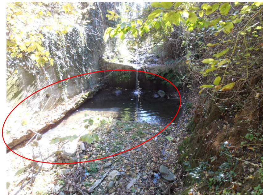
Rio Val Salice in str. Val Salice n. 34, erosioni dei fondi scorrevoli e delle briglie, e scalzamento dei muri d'ala, in Str. Val Salice n. 34
