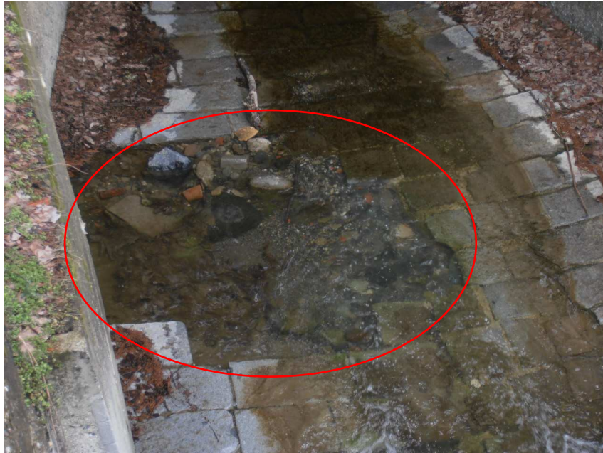
Rio Val San Martino, erosione del fondo scorrevole (evidenziato in rosso) con asportazione della pavimentazione in masselli di pietra
