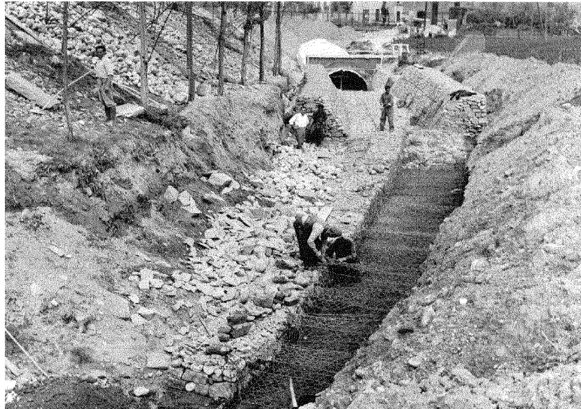
Rio Val San Martino in c.so Picco n. 104. Anno 1962: Realizzazione della sistemazione del rio con gabbionate metalliche costituenti fondo e argini.
