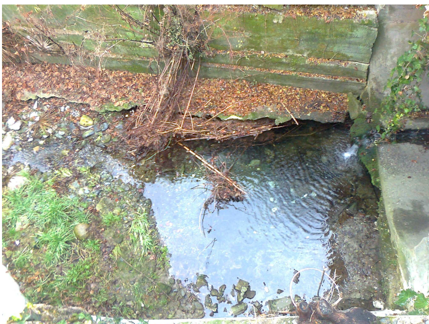
Rio Pattonera in Viale XXV Aprile 19, erosione della soglia di uscita della copertura.
