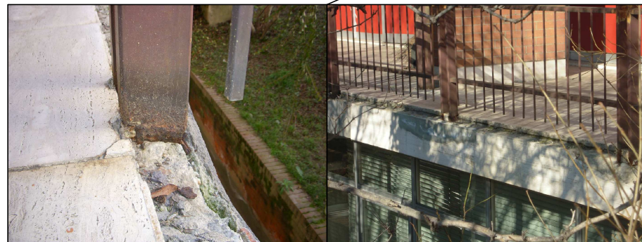
Cod. scheda 3.2.1 - Risanamento rivestimenti Sostituzione ringhiera pericolante
