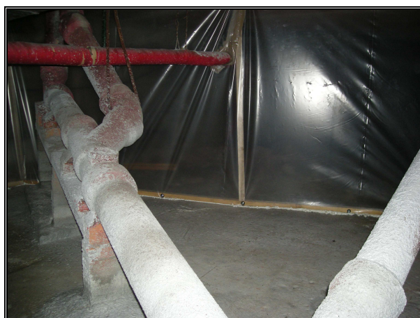
tubazioni di scarico piano interrato
