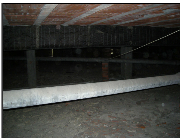
tubazioni di scarico piano interrato
