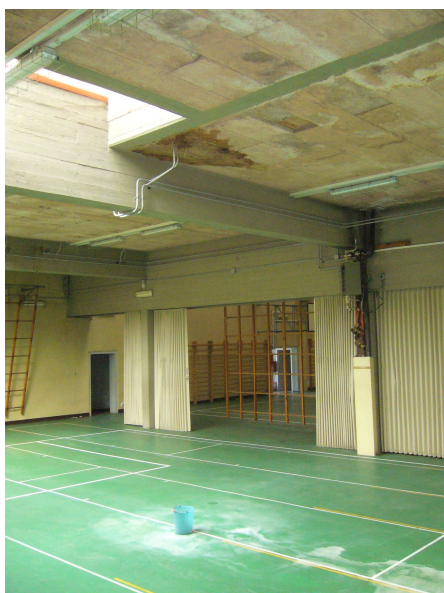
infiltrazioni locali palestre
