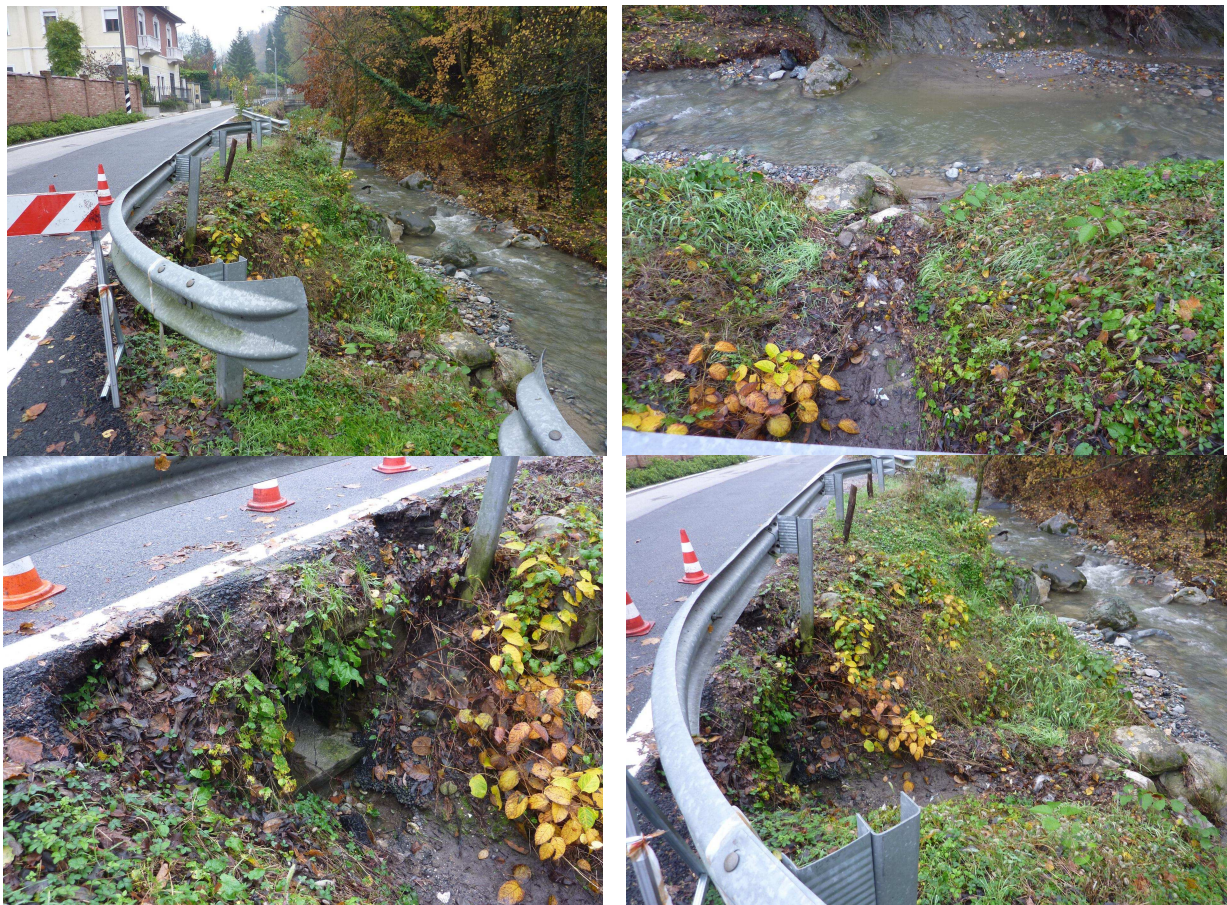
il cunicolo e la zona erosa
