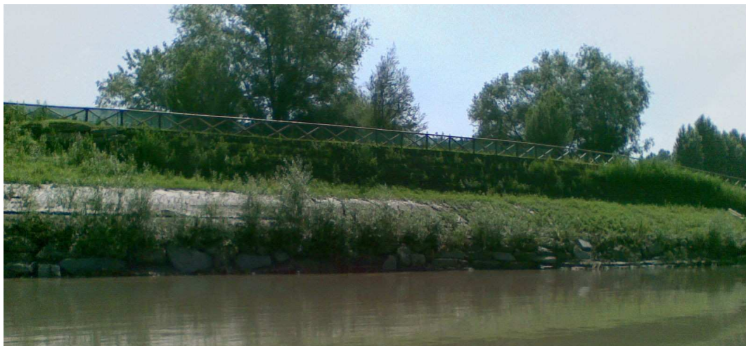
Sponda destra fiume Po a valle del Rio Sappone successiva ai lavori di "Riqualificazione ambientale zona Fioccardo - terzo stralcio". E' visibile la scogliera rinverdita con pali infissi realizzata al piede della sponda.
