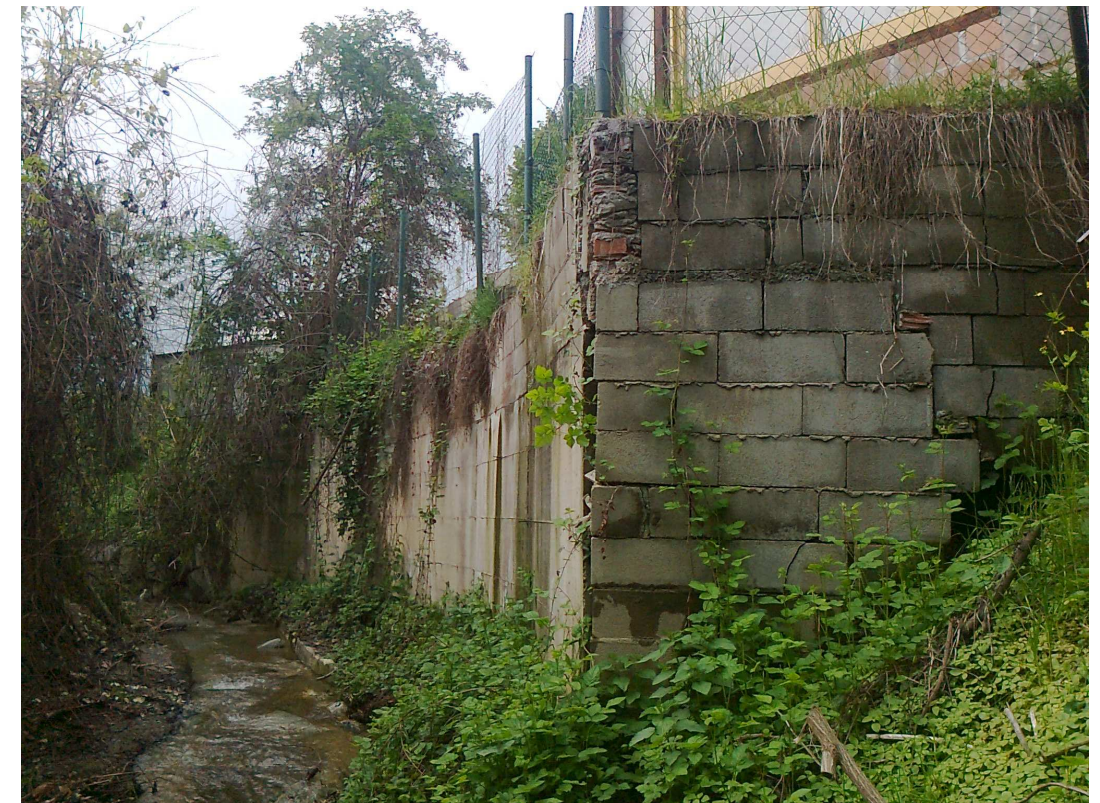
Figura 10 – Sponda destra del rio Sappone vista del muro in c.a. da sopraelevare
