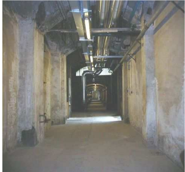
Piano interrato dorsali impianto idrico
