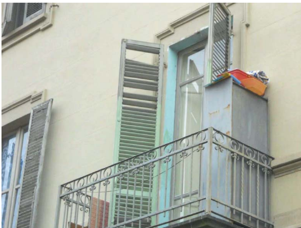
ESEMPIO DI SERRAMENTO CON GELOSIA DA SOSTITUIRE;
