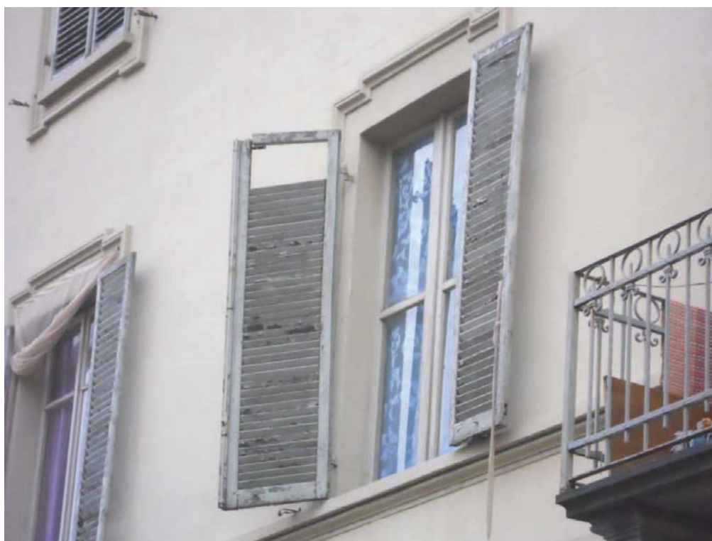
ESEMPIO DI SERRAMENTO CON GELOSIA DA SOSTITUIRE.
