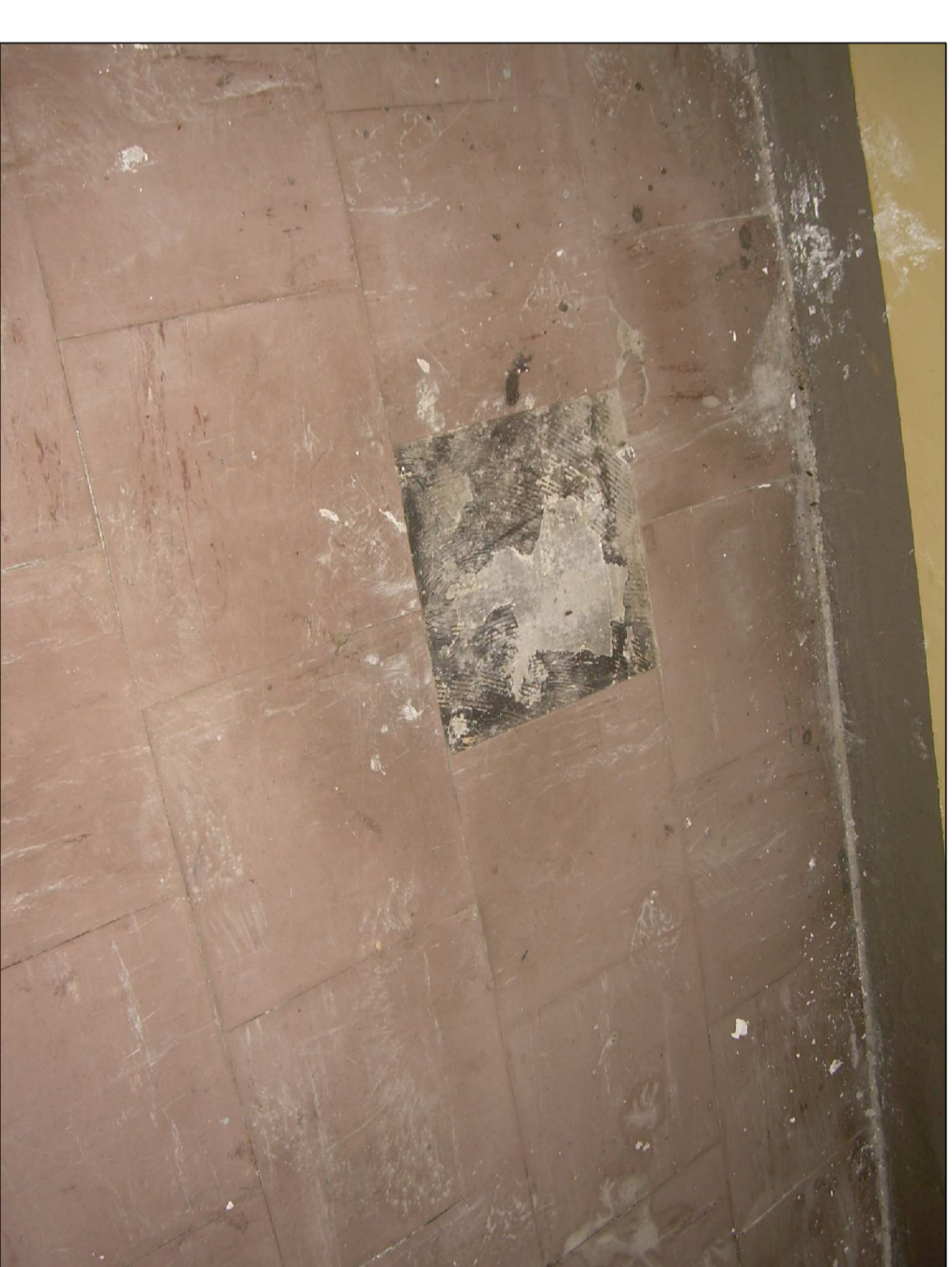
PAVIMENTO CABINA ELETTRICA
