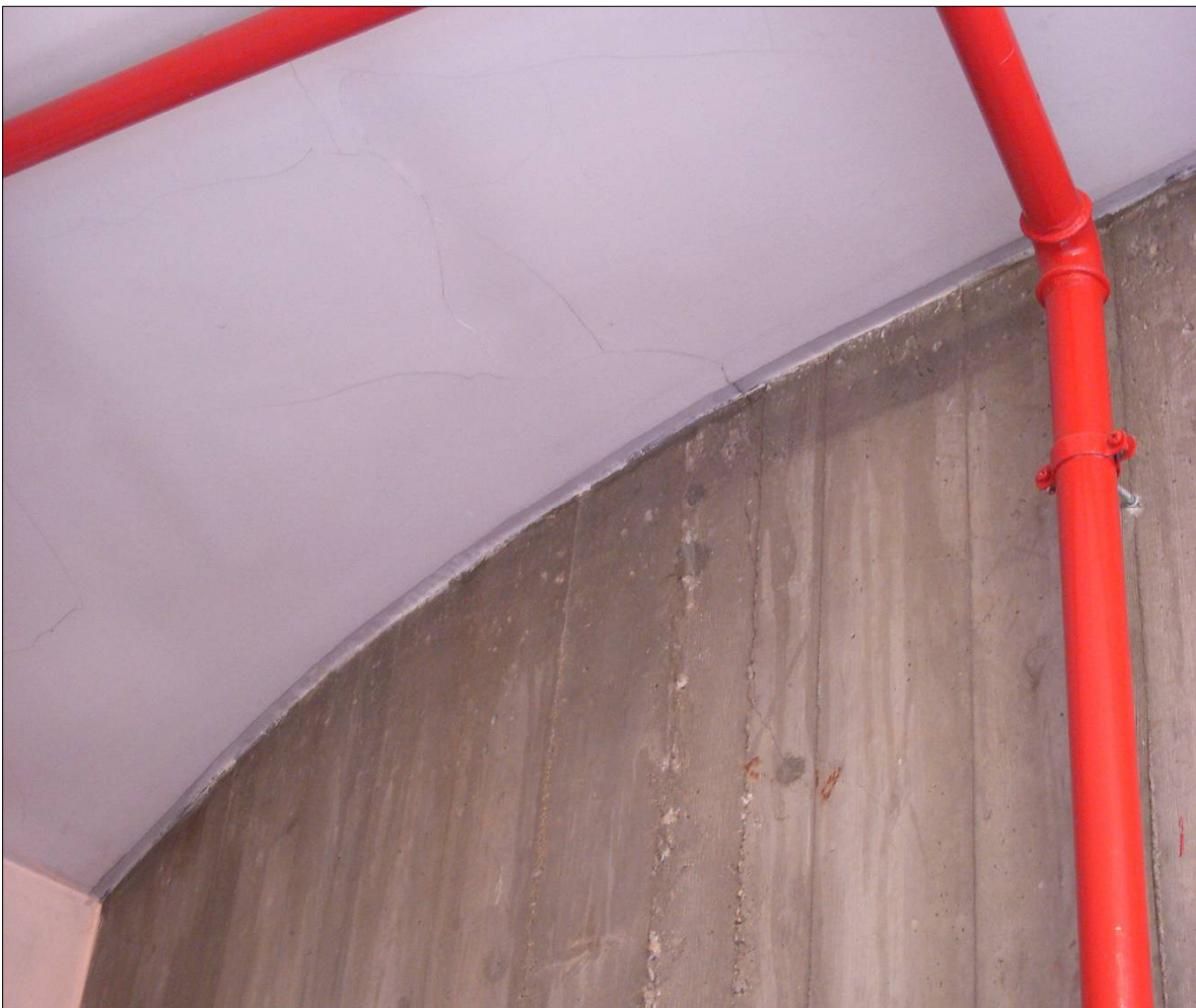
Figura 12 - Fessurazioni nel solaio di copertura del corridoio
