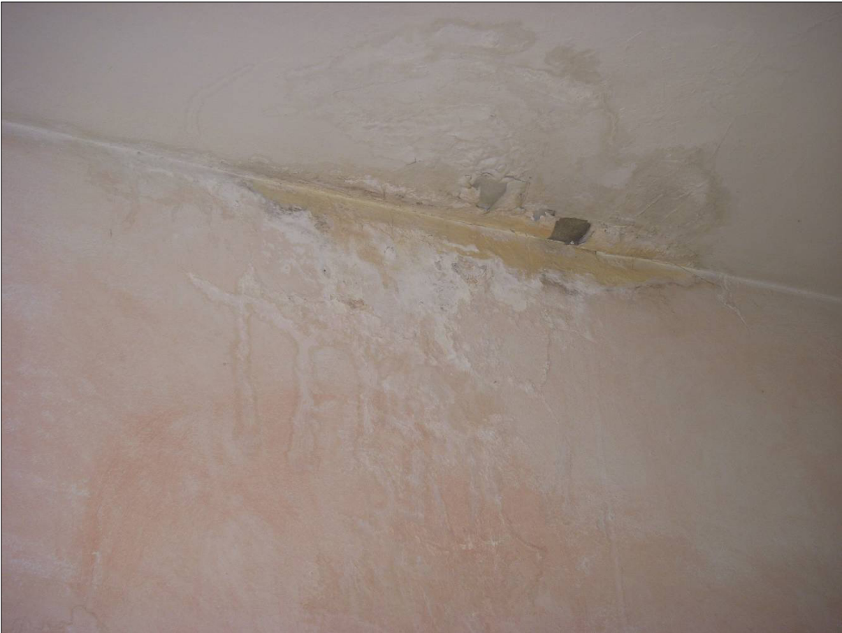
Figura 7 - Tracce di infiltrazione d'acqua in prossimità del laboratorio informatico
