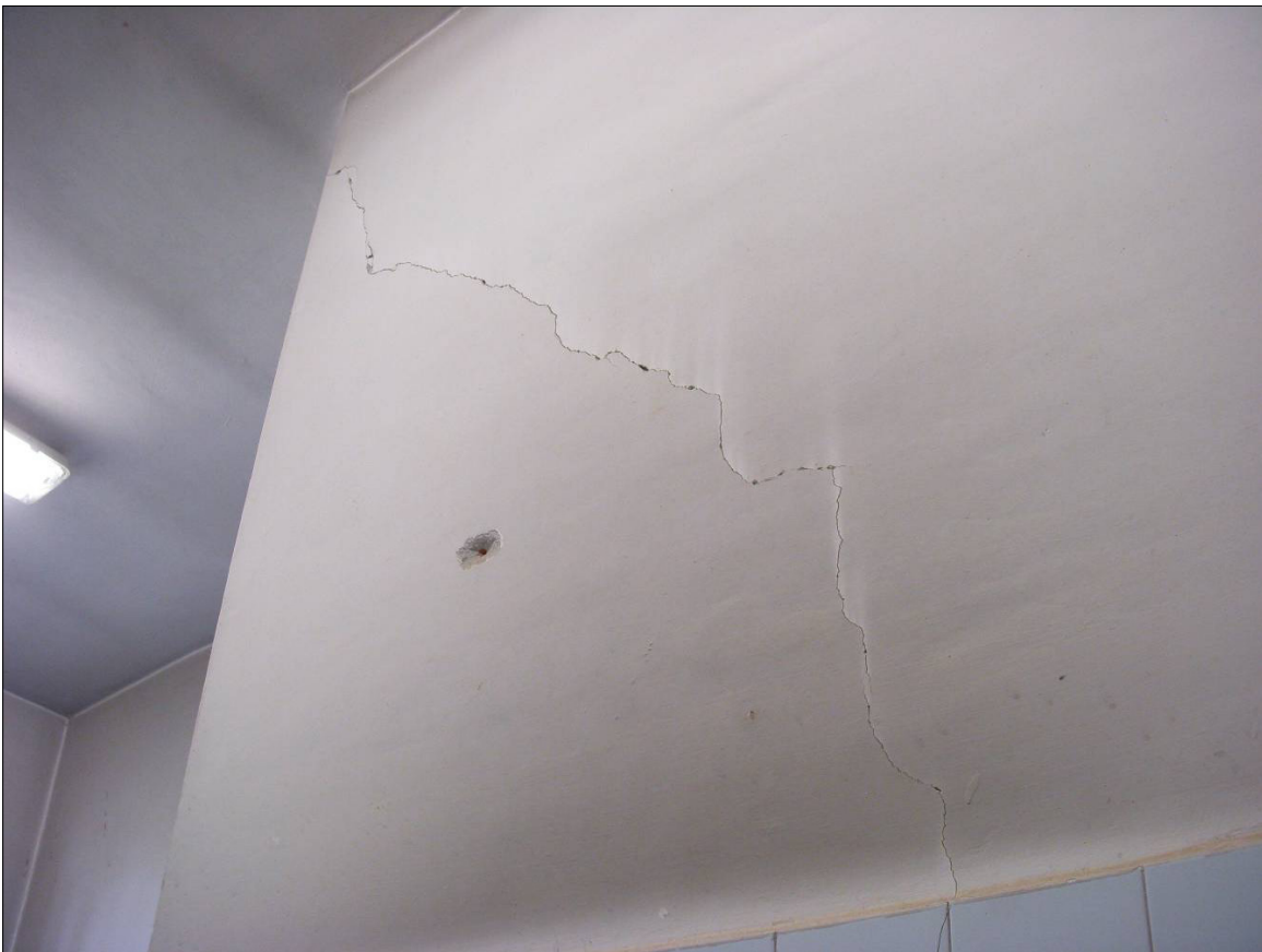
Figura 14 - Fessurazione diagonale nel tramezzo dei bagni maschili
