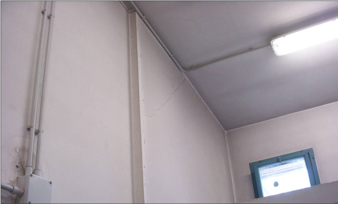
Figura 11 - Fessurazione nel tramezzo dei bagni maschili
