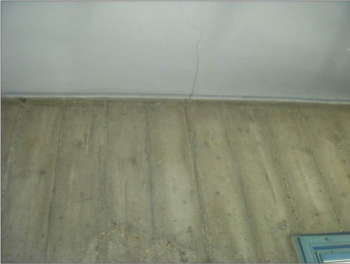
Figura 13 - Fessurazione nel solaio di copertura parallela al senso di orditura
